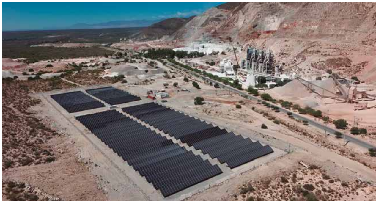
El parque fotovoltaico representa el 40% de las necesidades energéticas de Caleras San Juan
