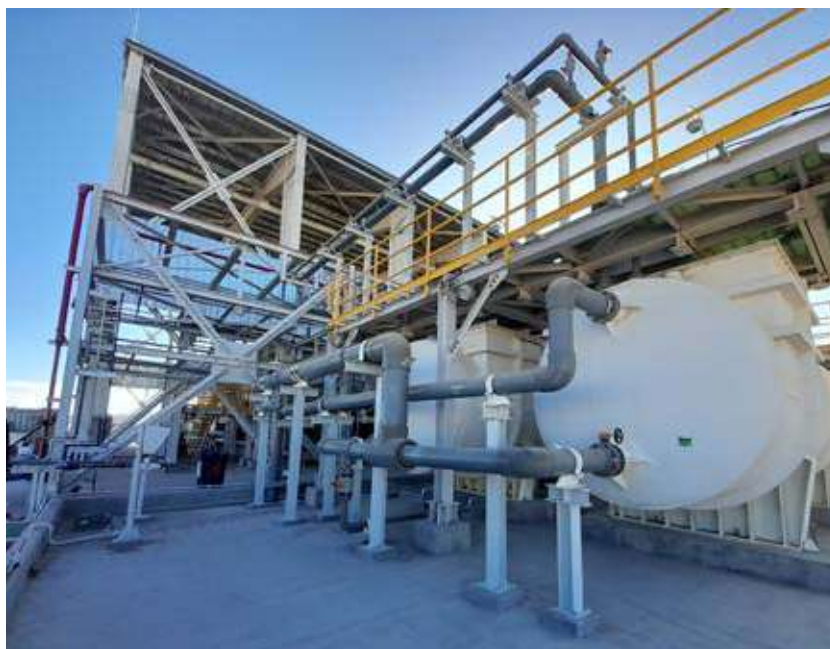
Tuberías de CPVC Schedule 80 en una planta de procesamiento de Carbonato de Litio a partir de Salmueras, en el Triángulo del Litio
